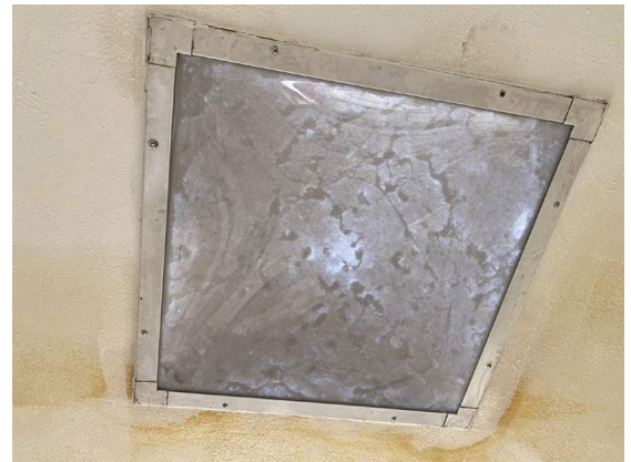
Dirty skylight | A6
